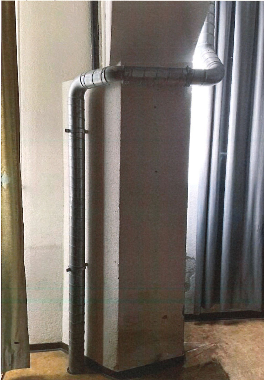
Lüftungsleitung bei Bühne
