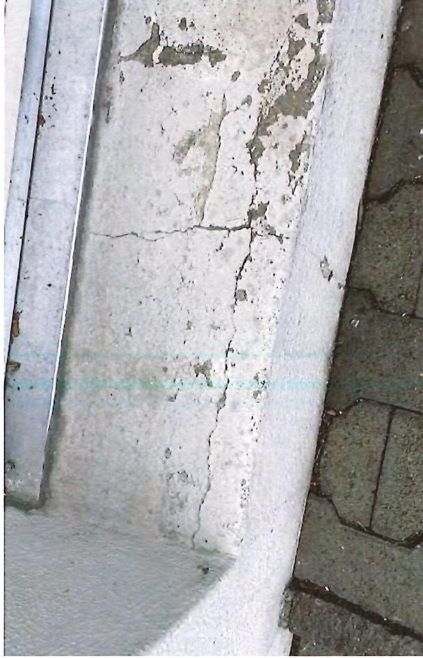
Risse im Sockelbereich
