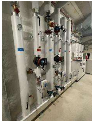
Riedmatt 3: UST Heizverteiler
