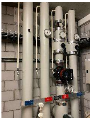
UST Heizkörper Mehrzweckhalle
