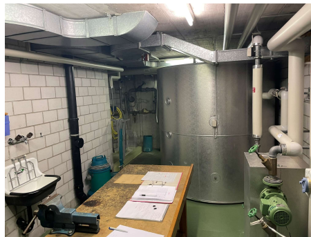
Kindergarten Althau / Untergeschoss: Warmwasserspeicher 3'000Liter mit Magro- Ladung (nicht in Betrieb). Warmwasser erfolgt elektrisch.
