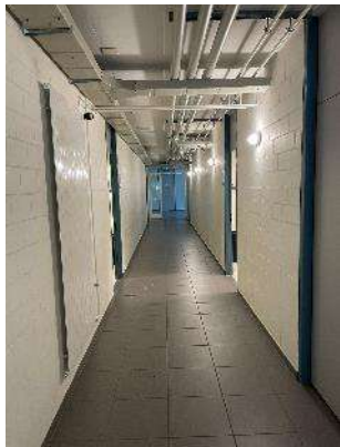
Mehrzweckhalle: Erschliessung der Leitungen im Korridor
