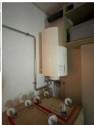
Warmwasser erfolgt elektrisch
