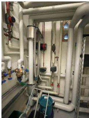
Riedmatt 1: UST Heizverteiler
