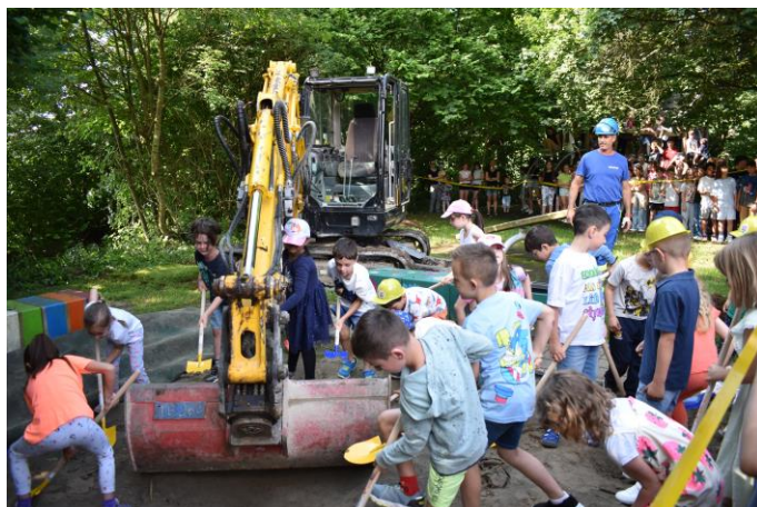
Spatenstich für das Projekt Sanierung und Erweiterung Kindergarten «Althau» mit Garderoben für den FC Niederwil
